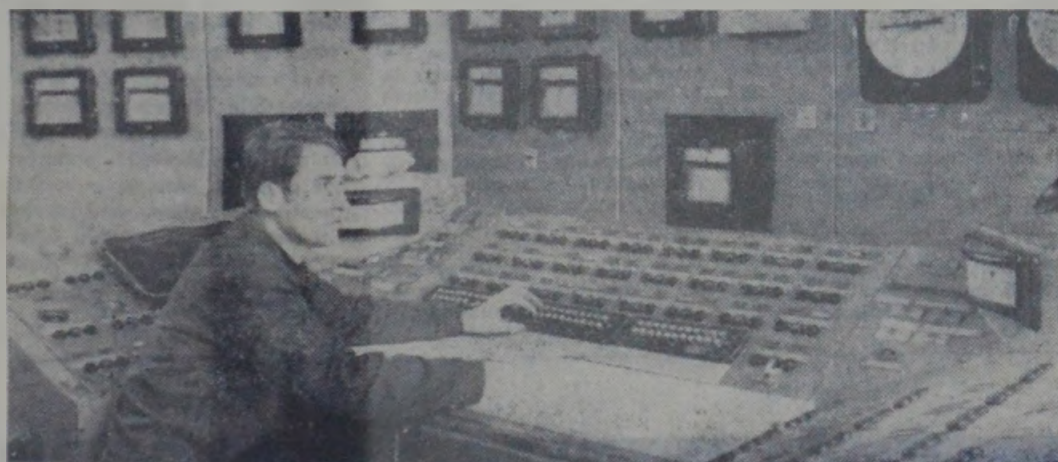
U.F.S. Savinești, la tabloul de comandă din secția de preparare a aerului.
